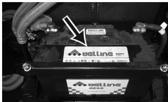
在蓄电池顶部
